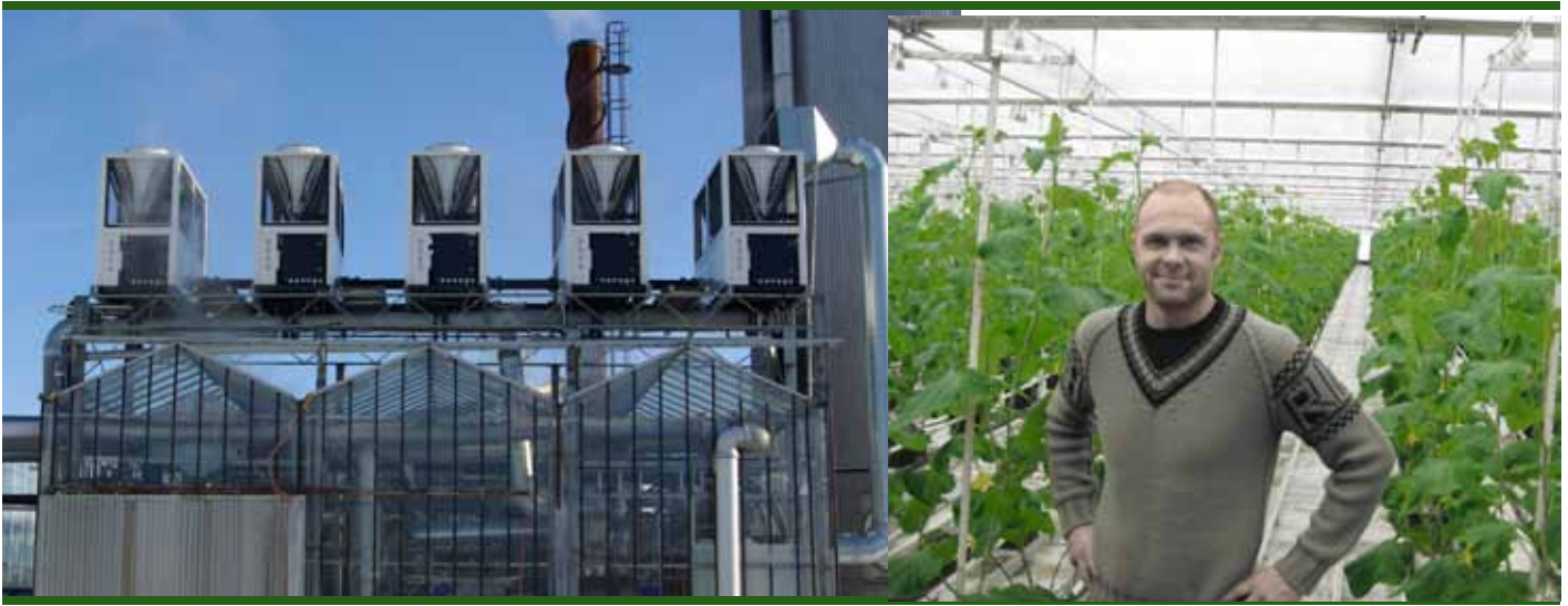
En udda placering av värmepumpar, men så här säkerställer vi luftflöde och samspel med gasturbinen effektivt
