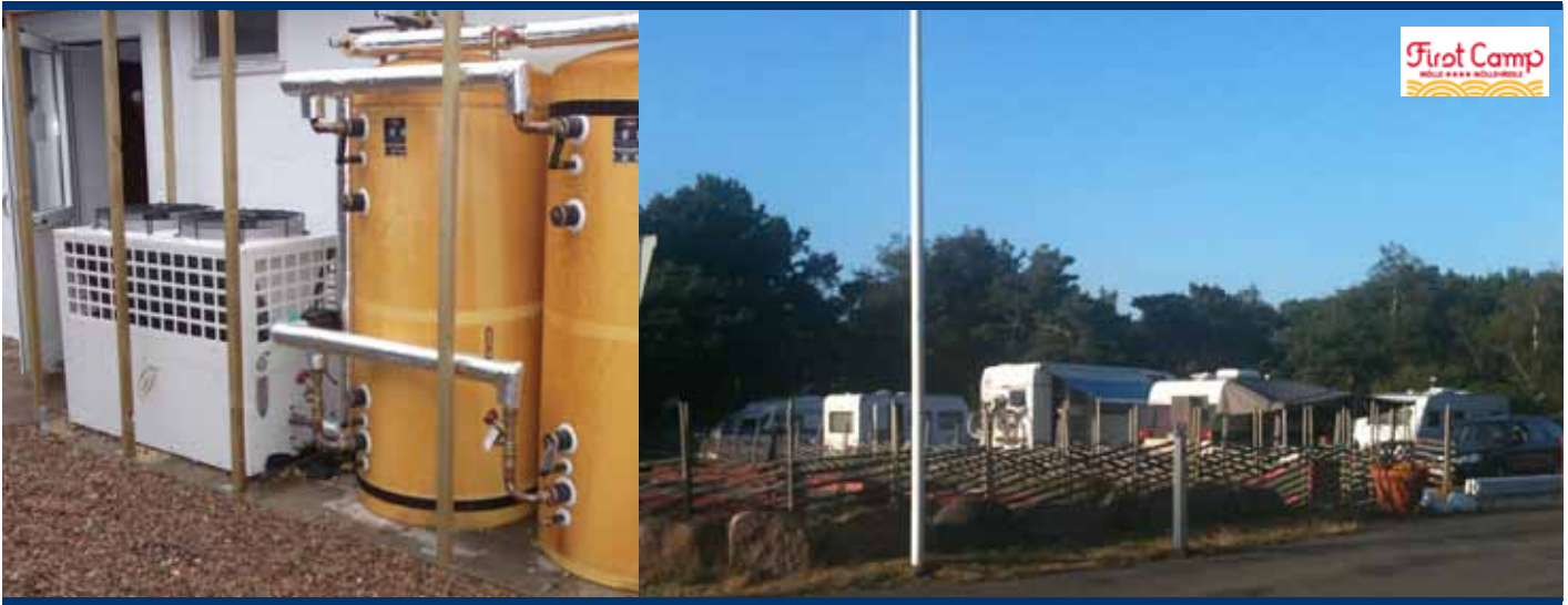
Installationen på Lerbergets camping.
